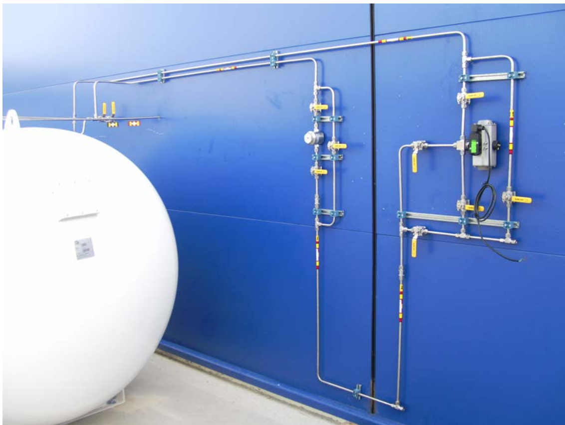
Figura 6.7 Instalación de hidrógeno
