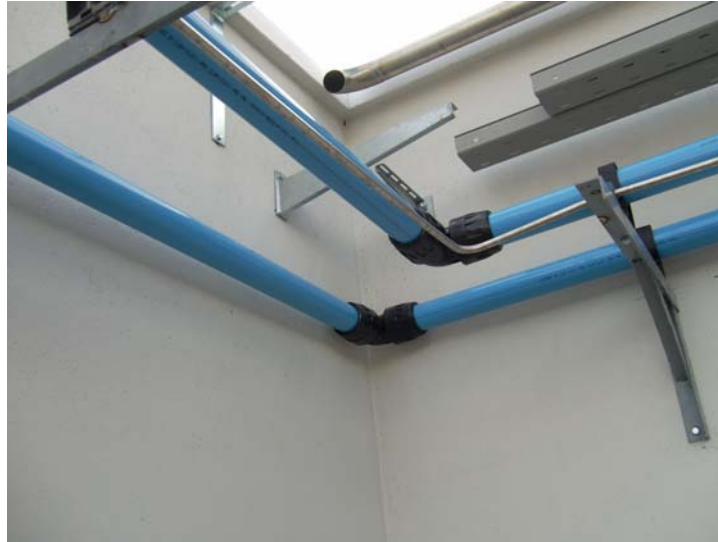
Figura 3.39 Tuberías de hidrógeno
