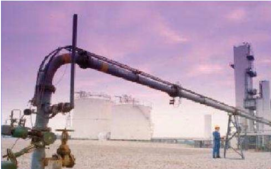
Figura 3.31 Gaseoducto de distribución de hidrógeno
