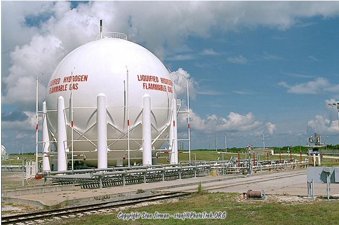
Figura 3.15 Tanque de almacenamiento de hidrógeno líquido con forma esférica situado en las lanzaderas de despegue de la NASA
