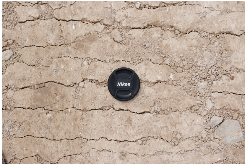
Figur 22 - Exempel på en oönskad stabiliserad yta. Sprickorna beror på dålig bärighet i underliggande lager. Foto: Per Lindh.
