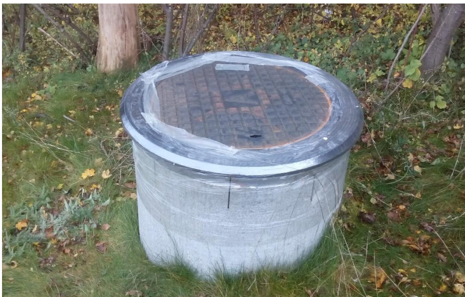
Figur 3.3. Gasbrunn tätad inför mätning. Foto: Ida Arvidsson.
