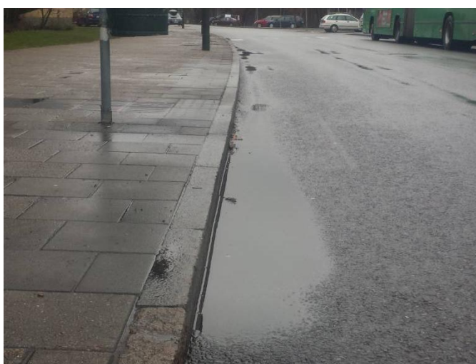
Figur 2.7 Otillräcklig ytvattenavledning på busshållplats Kronetorpsgatan B, Malmö.
