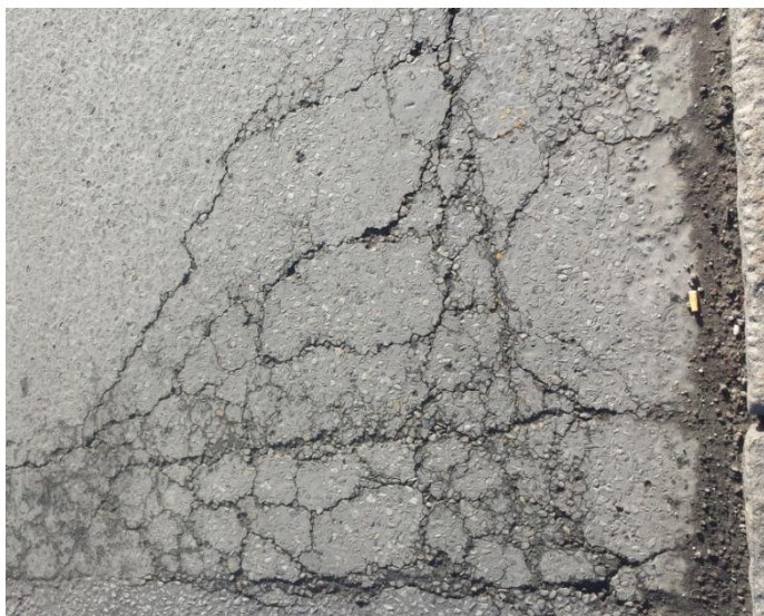
Figur 2.5 Krackelering på busshållplats Professorsgatan A, Malmö.
