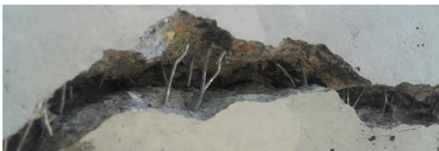
Bild 3. Stålfibrer i sprucken betong.
