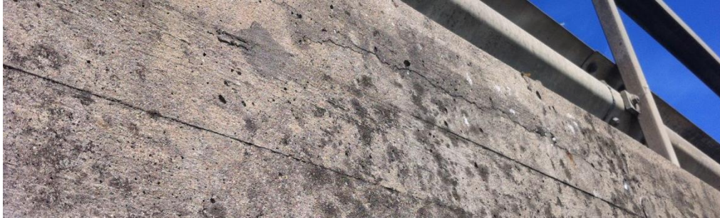
Figur 34: I högra delen av bilden syns den längsgående spricka som följer armeringen i kantbalken på cykelbron.
