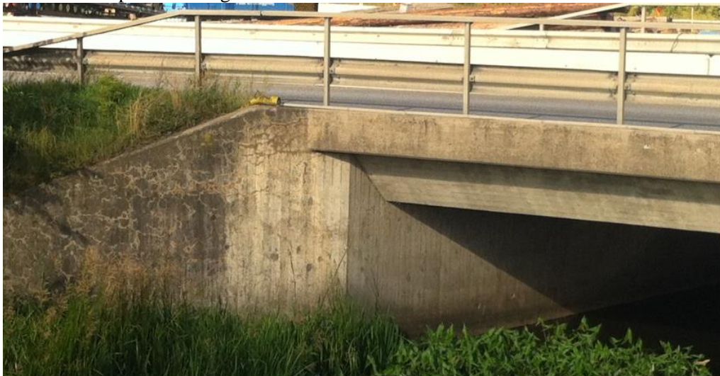
Figur 31: Tydlig sprickbildning på vingmuren på en vägbro förmodligen orsakat av alkaliballastreaktioner.
