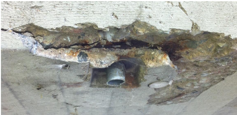
Figur 32: Armeringskorrosion kring ett grundavlopp under vägbrons farbana där täcksiktet har sprängts bort.
