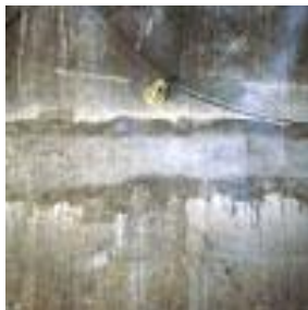
Figur 27: En spricka lagad genom torrpäckning (Basham, 2006).
