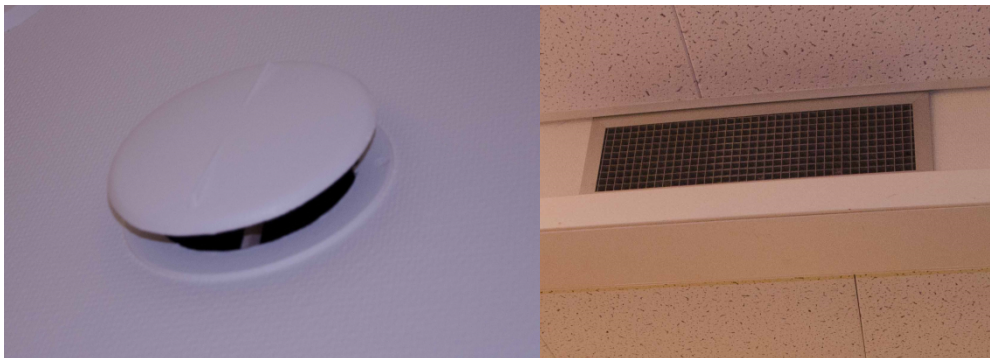
Figur 25. Från- och tilluftsdon.
