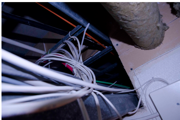
Figur 9. Kabelldragning som bryter brandcellsgräns ovanför en av dörrarna på barnakuten..
