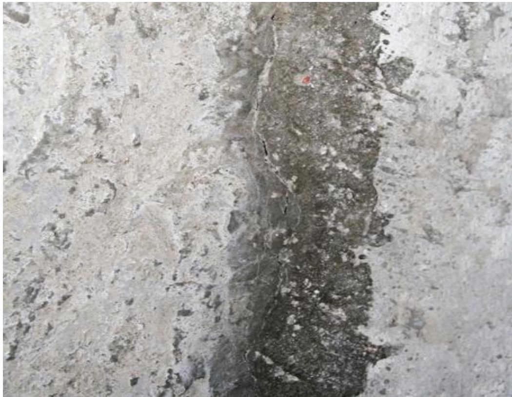
Figur 5.17: Krympspricka mellan igjuten betong och HD/F-platta.
