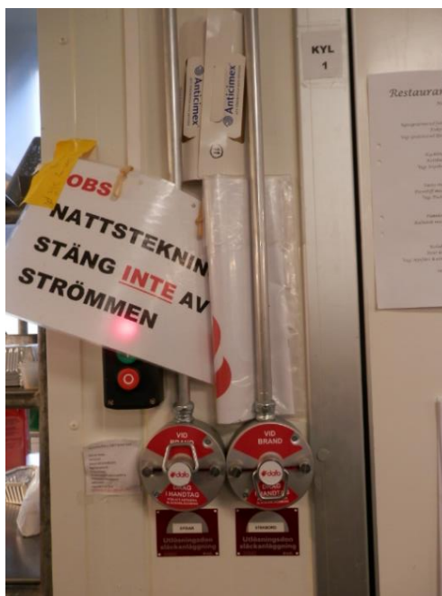
Figur 39. Aktiveringsanordning för punktsprinklers till stekbord och spis.
