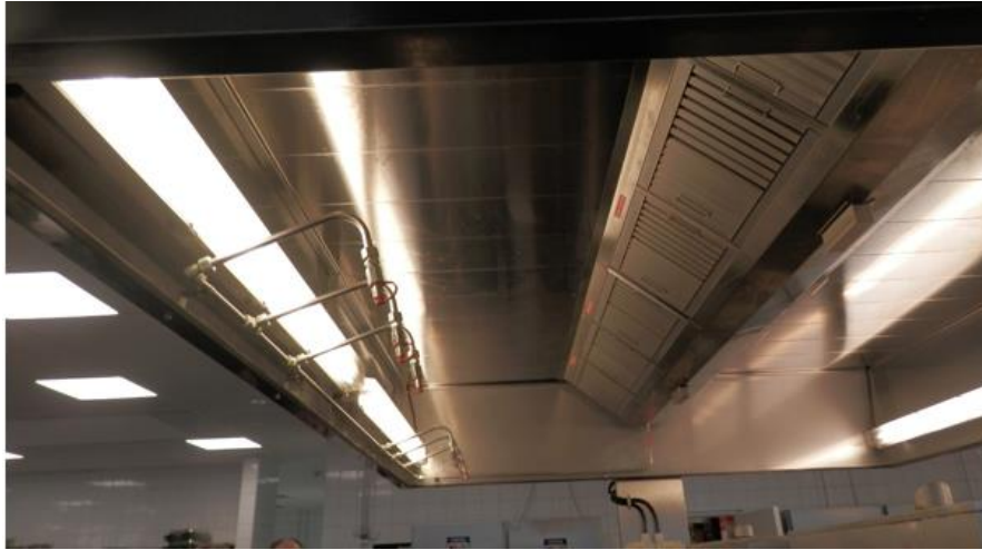
Figur 47. Punktsprinklers ovanför stekbord.
