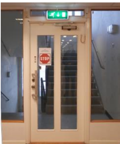
Figur 38. Skylt som sitter på dörren till en av utrymningsvägarna i Lernias lokal
