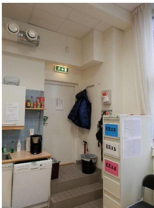
Figur 34. Utrymningsväg som leder genom kontoret.
