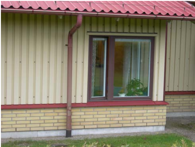
Figur 4-23 Vid platsbesöket noterades att en del fönster stod på glänt.
