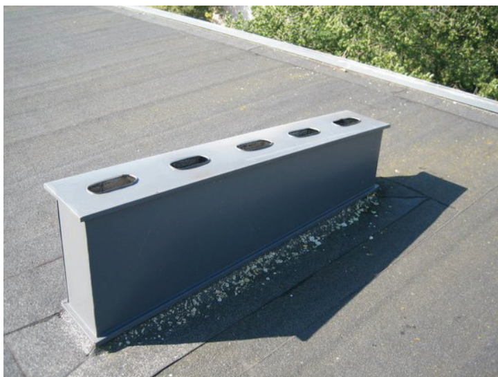
Bild 3.2 Frånluftskanaler på taket från sovrum (Martin Edfeldt)
