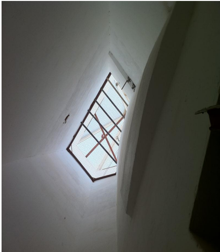
Foto 16. Visar insidan på modern vindfångare
