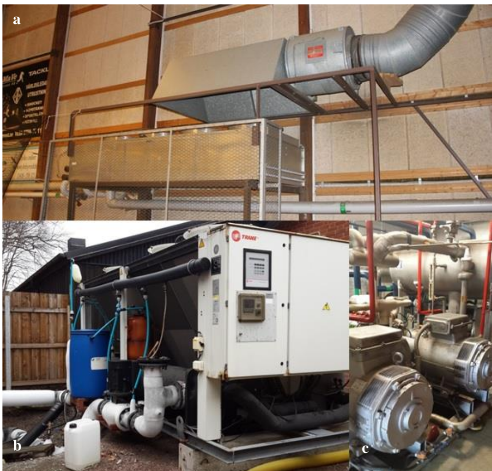
Figur 15: Kollage över ishallens läktarvärmesystem (a), utomhuskylmaskin (b) samt inomhuskylmaskin (c)
