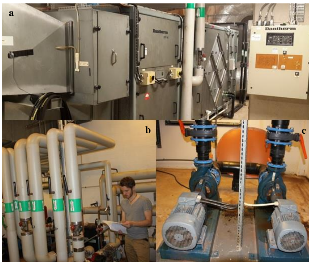
Figur 30: Kollage över Karlslundsbadet ventilationssystem (a), fjärrvärmecentral (b) samt cirkulationspumpar (c)
