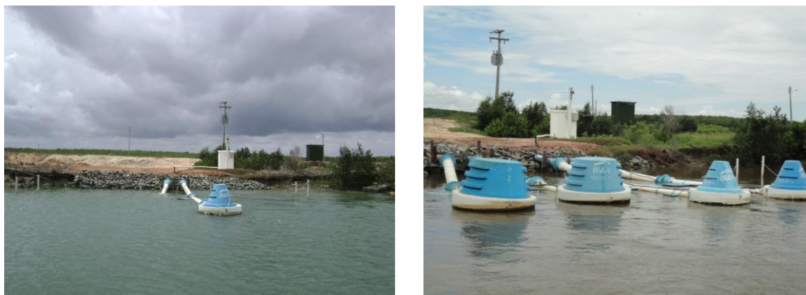
Figura 3 - Bombas de captação de água para os viveiros de camarão
