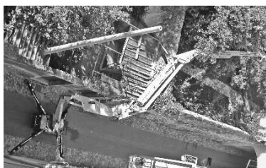
Risultato del crollo della PLE
