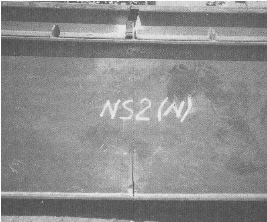
Fig. 10. Picture of uncompressed girder crack NS Rys. 10. Zdjęcie pęknięcia dźwigara niesprężonego NS
