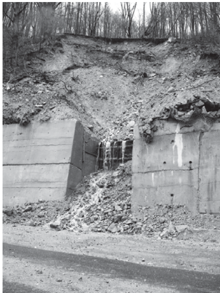
Figure 9 The landslide from km 110+700 (Cârligul Întors)
