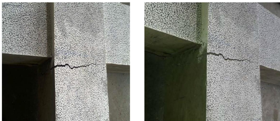
Figura 17. Agrietamiento debajo de las vigas de concreto. Fuente [2]
