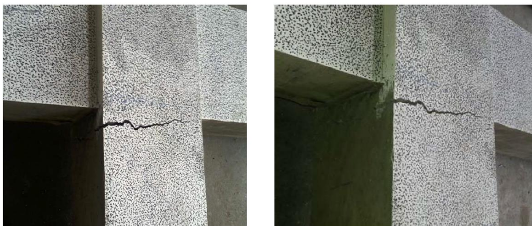
Figura 7. Agrietamiento debajo de las vigas de concreto. Fuente [1]
