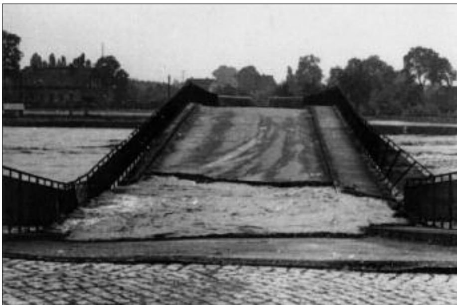
Eingestürzte Brücke der Reinholdshainer Straße nach Jerisau.
