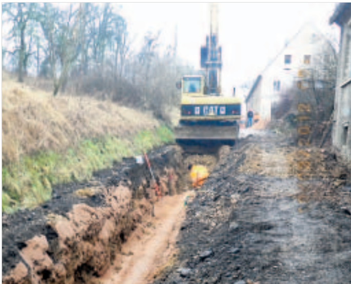
Durch die Entwässerung über eine Rohrleitung ist eine breitere Fahrbahn am Dobritzer Berg möglich. Foto: Stadt Meißen
