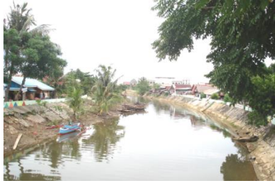
Gambar 2. Kondisi tanggul pada bibir sungai sebelum dilakukan perbaikan
