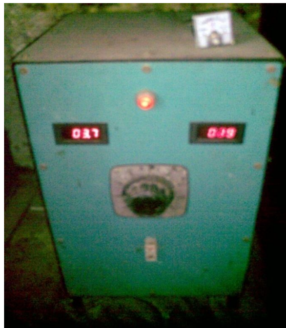
Gambar 7 : Rectifier Sumber : Photo Scan (2011)
