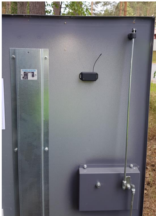
Kuva 24. Sensori kiinnitettynä puistomuuntamon oveen
