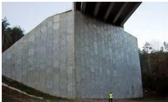
Figura 2.2: Estribo formado por el muro frontal y muros de ala o aletones.
