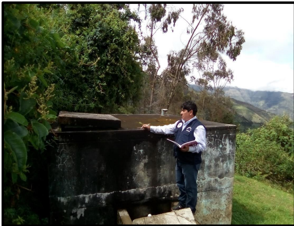
FotoN°8 Reservorio en malas condiciones
