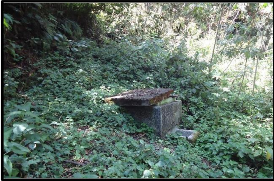
Figura 10.- Captación Siracachayoc LlañucanCHA
