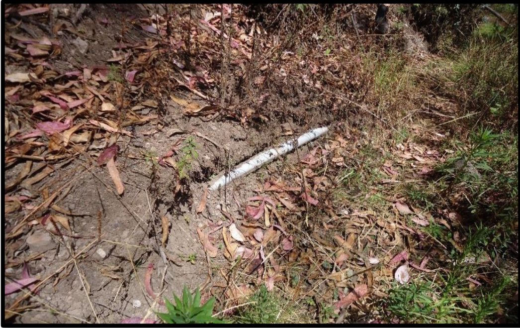
Foto N°3 Líneas de Conducción
