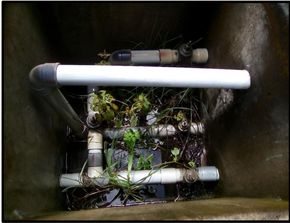
FotoN°7 Válvulas inoperativas oxidadas del reservorio
