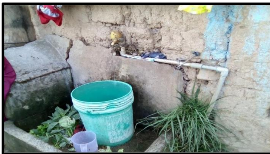
Figura 14.- Estado de conservación de piletas domiciliarias
