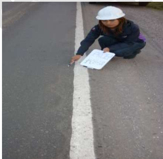
Fotografía 5.39: Deformación por corrugación 1408 + 500 km.
