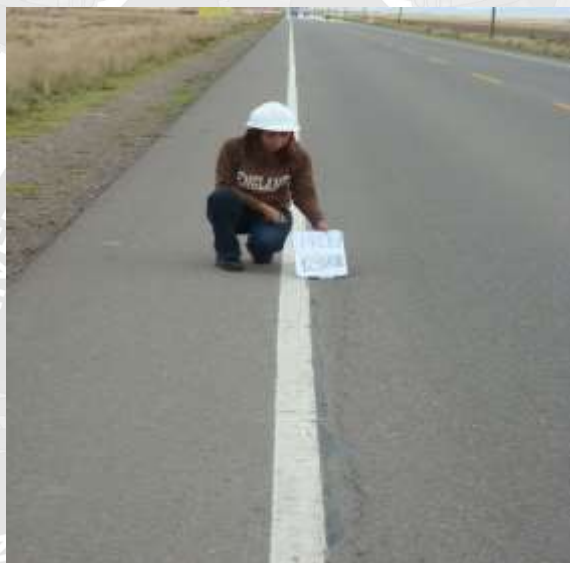
Fotografía 5.20: Fisura longitudinal 1250 + 000 km.
