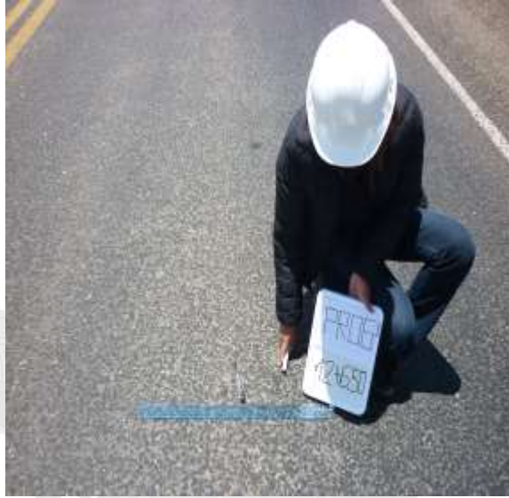
Fotografía 5.4: Pérdida de agregados 12 + 650 km.
