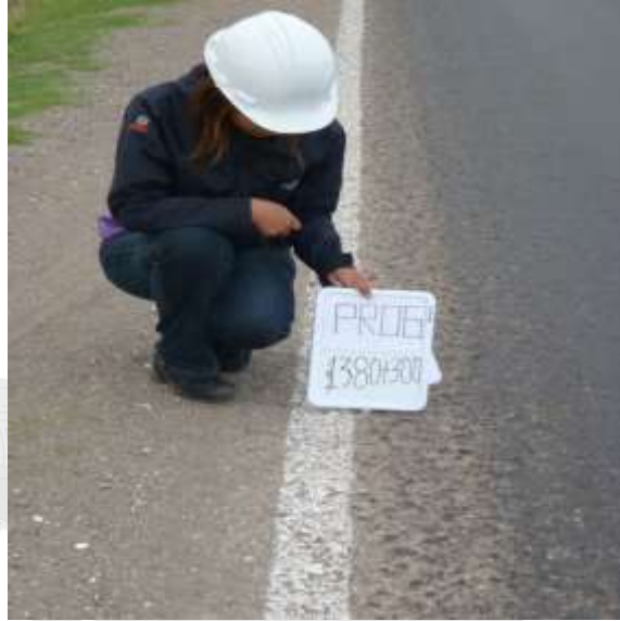
Fotografía 5.38: Pérdida de agregados 1380 + 300 km.
