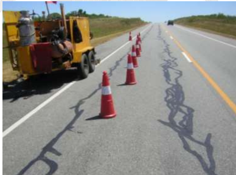
Fotografía 6.1: Sellado de fisuras y grietas.
