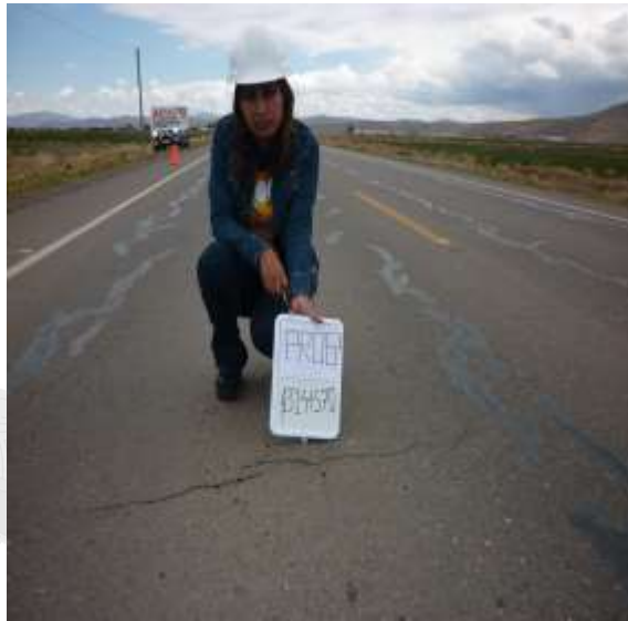
Fotografía 5.7: Fisura transversal 1314 + 570 km.
