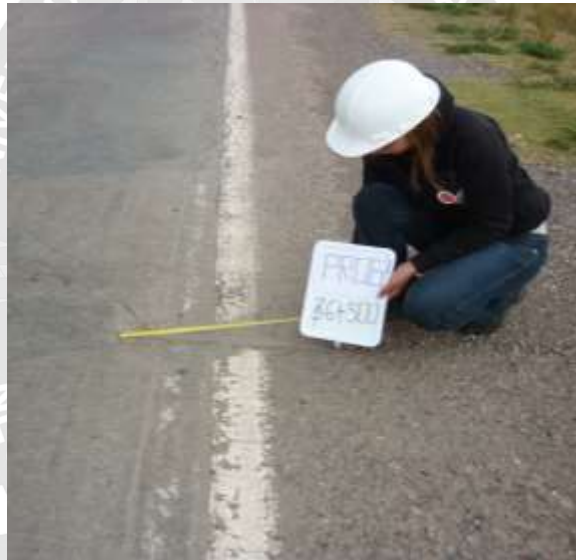
Fotografía 5.33: Fisura transversal 36 + 500 km.
