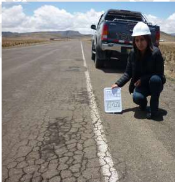
Fotografía 5.5: Fisura de piel de cocodrilo 32 + 120 km.
