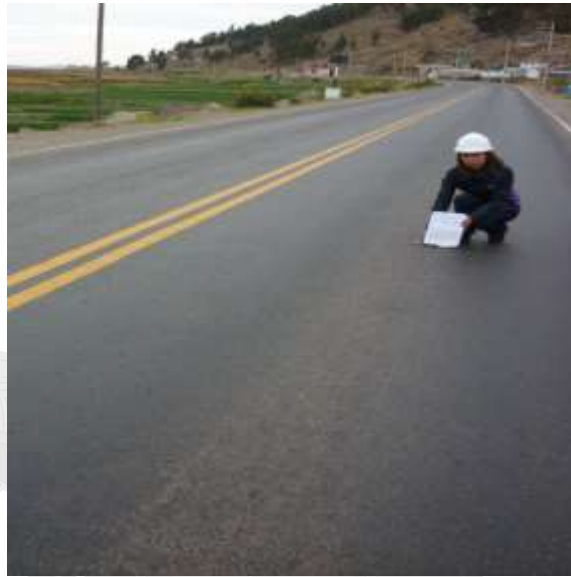
Fotografía 5.34: Desgaste superficial 1368 + 100 km.
