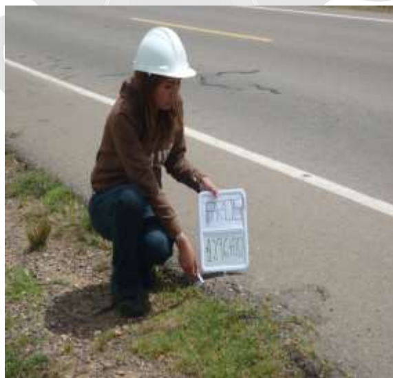
Fotografía 5.22: Desintegración de bordes 1296 + 000 km.
