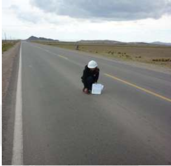
Fotografía 5.30: Desgaste superficial 13 + 400 km.
