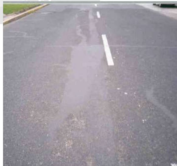
Fotografía 4.16: Exudación de asfalto.
