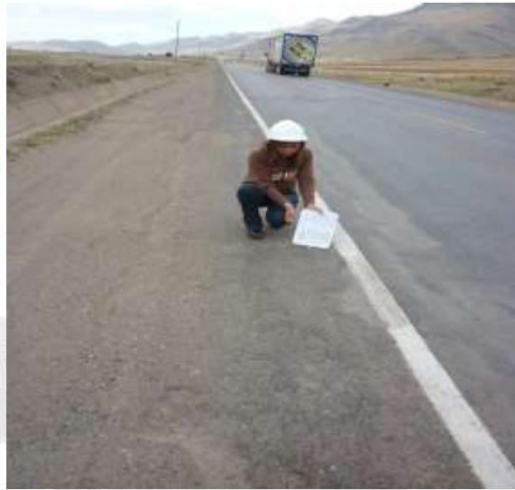
Fotografía 5.21: Deformación por corrugación 1290 + 100 km.
