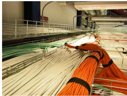
(D) Cables above the racks.
