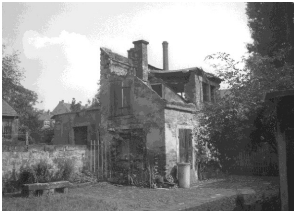
Abb. 23: Verfallenes Haus in der Äußeren Neustadt Foto: ENDERLEIN 1991
