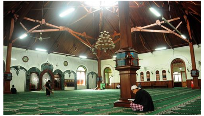
Gambar 13. Struktur Rangka Atap dan Soko Guru pada Masjid Jami' Malang (Sumber : Satrya, 2013)
