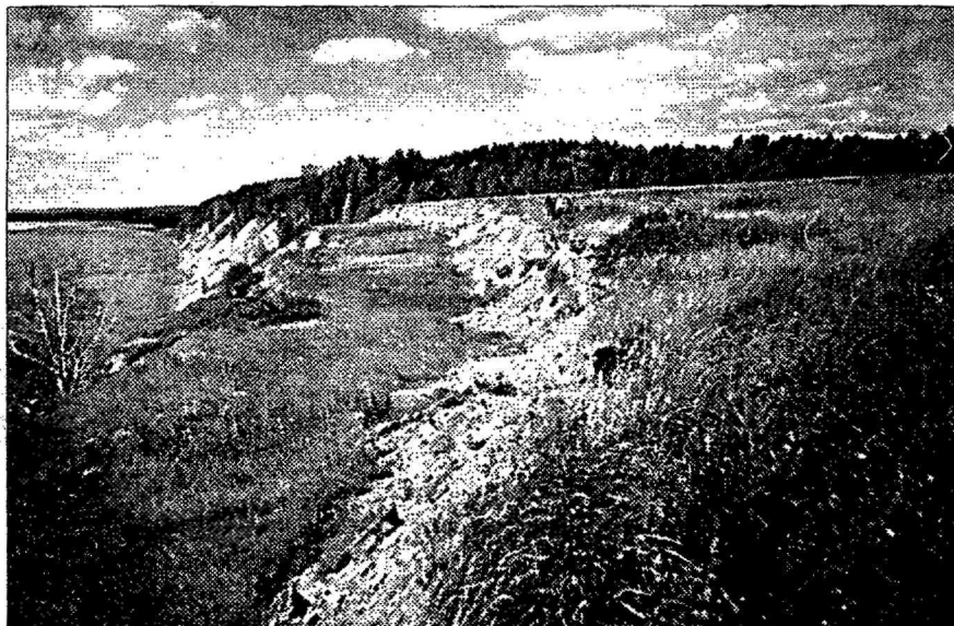
Рис. 6.12. Оползень на левом берегу р. Вятки в районе с. Крымская Слудка (ключевой участок № 55)
