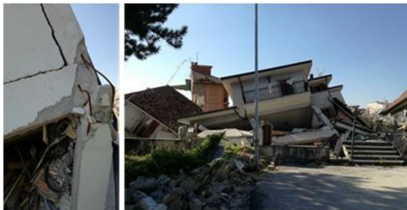
Figura 2 - Amatrice (Rieti): edifici in c.a. crollati - Amatrice (Rieti): Examples of reinforced concrete buildings collapsed.
