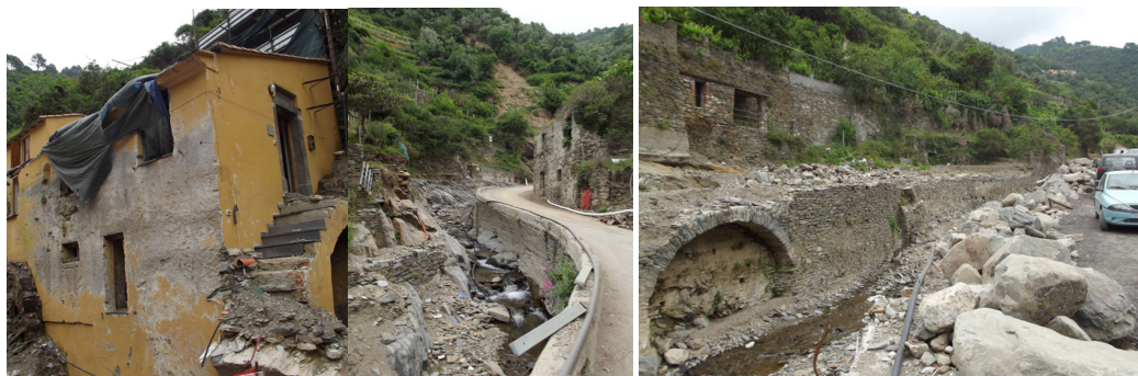
Figura 2. Esempi di danni a manufatti edilizi lungo il corso del Vernazzola (foto P. Maschio).
