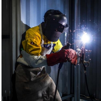
Figura N° 2.77: Calificación de soldadura
