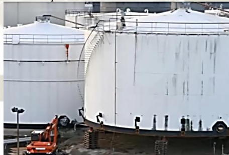
Figura N° 2.10: Tanque de almacenamiento techo tipo cono
