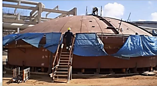
Figura N° 2.11: Tanque de almacenamiento techo tipo domo
