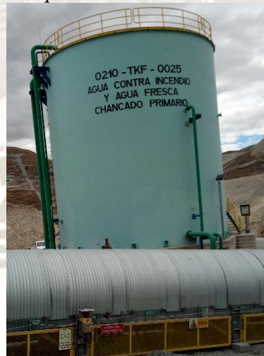
Figura N° 2.1 Tanques de almacenamiento vertical
