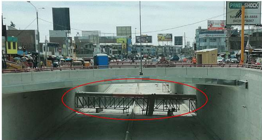
Figura 2. 31 : Interferencia no detectada a tiempo entre tubería de drenaje y recorrido de vía, Ovalo de los Bomberos Arequipa, Perú.
