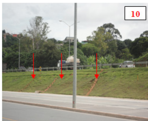
Figura 10 – Trilhas e infiltrações na MG-010 próximo a Cidade Administrativa de Minas Gerais.
