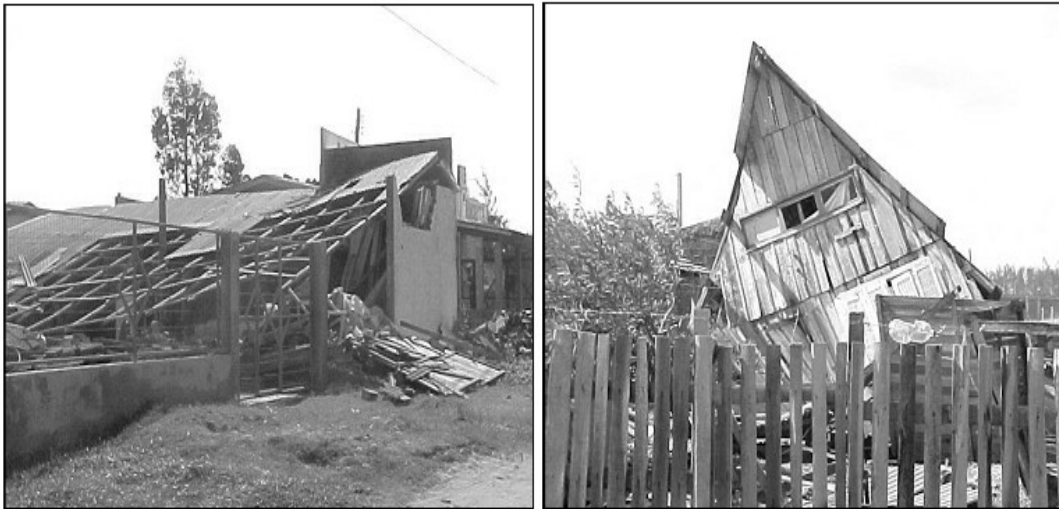
Figuras 10- Moradias destruídas e danificadas pelo Catarina no município de Torres em março de 2004. Fonte: Defesa Civil do Estado do Rio Grande do Sul.
