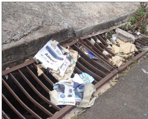
Figura 4 – Exemplo de acúmulo de resíduos em bueiro utilizando para discussão. Fonte: Autores, 2013.
