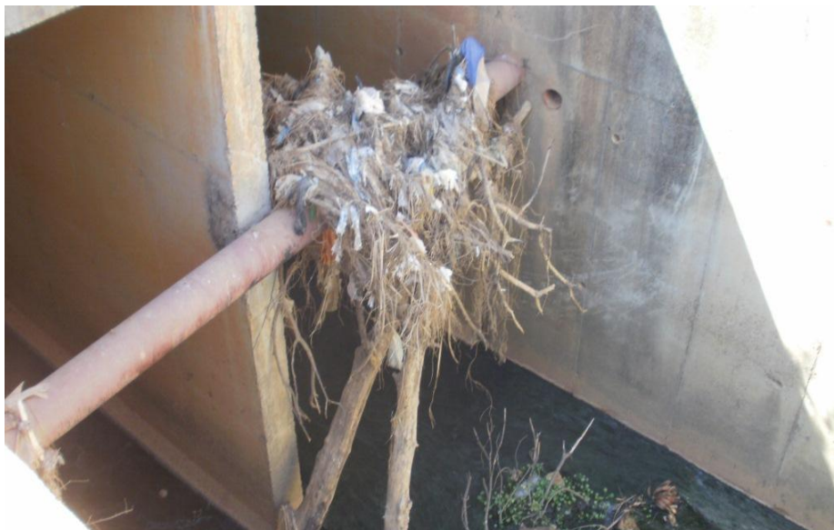
Figura 06 - Resíduos sólidos presentes em uma tubulação do canal na foz do rio Cintra.
