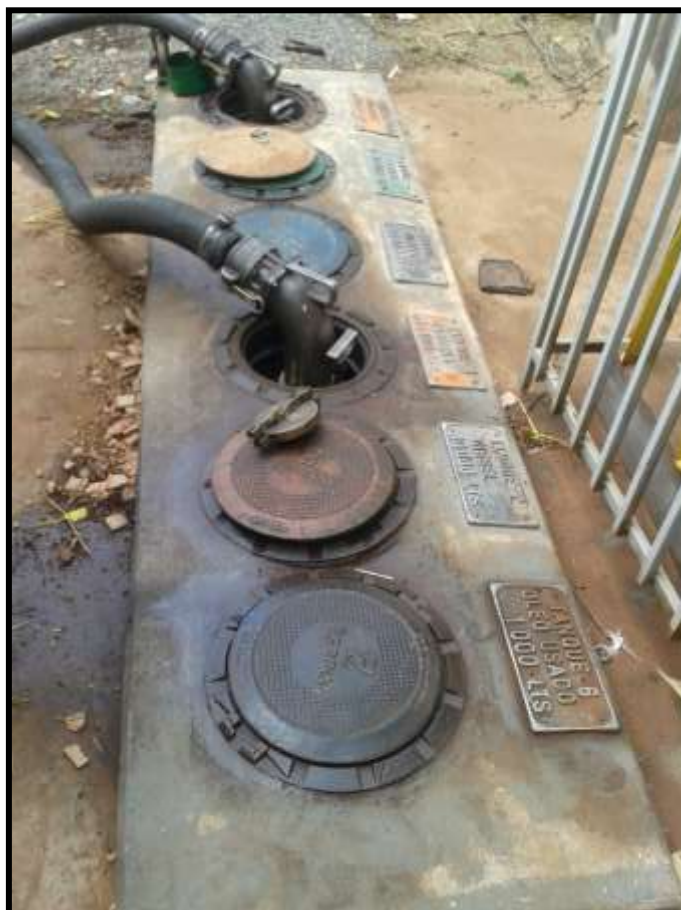
Figura 2 – Tanque subterrâneo que armazena o óleo lubrificante usado em um dos estabelecimentos entrevistados, no município de Terezópolis de Goiás - GO.
