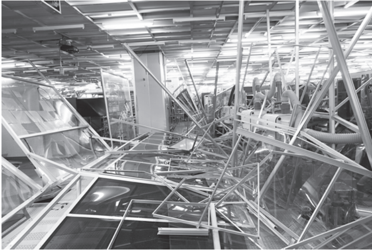
写真7 1号棟6階クリーンルームの損壊
