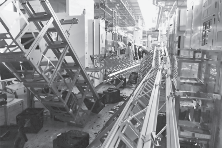
写真6 自動搬送装置のレール落下
