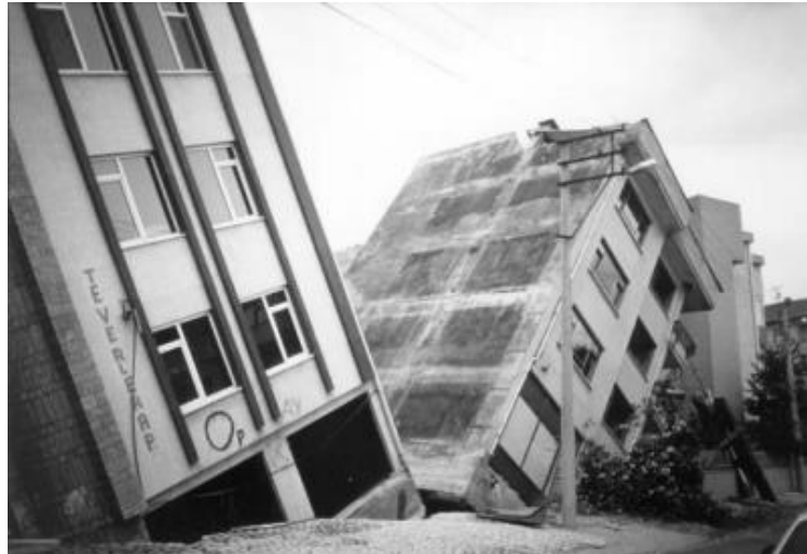
Şekil 2.9: 1999 Kocaeli depremi sonrasında Adapazarı’nda zemin etkisi sebebiyle oluşan yapısal hasara tipik örnek
