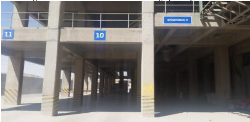
Figura 121. Señalización Zonas De Carga por Fajas
