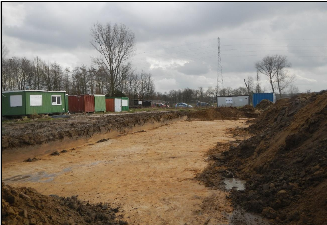
Figuur 17: Overzicht van zone 2 met de werfinrichting van de bouwheer, waardoor er niet volledig tot aan de opgraving uit 2012 kon worden gegraven.
