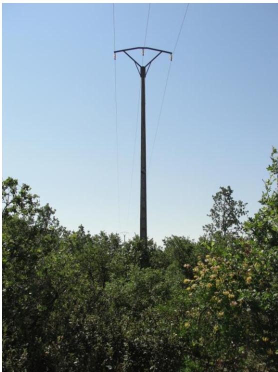
Figura 2. Línea eléctrica 33 KV a su paso por el monte/Fuente: archivo propio
