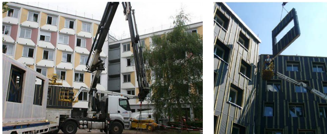
Figure 25 : rénovation de la cité universitaire La Bourgeoinière à Nantes avec des panneaux à ossature bois par Cruard charpente
