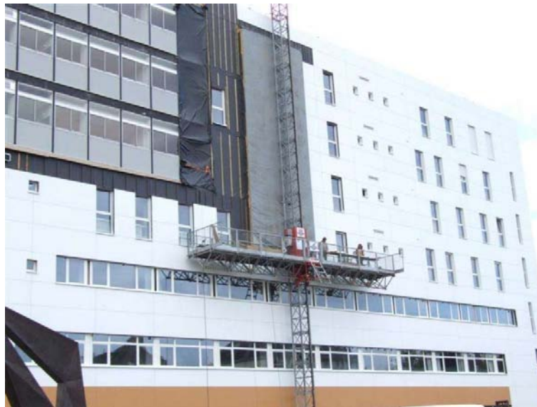
Figure 27 : rénovation du lycée Pavie à Guingamp par Turmel : de gauche à droite, façade existante, façade protégée par des bâches, panneaux à ossature bois posés, vêtue extérieure en cours de pose et posée
