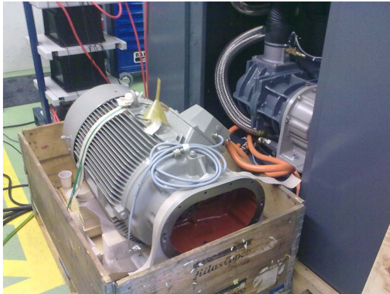
Fig. A.6: Siemens' 32 kW D-91066 Erlangen Compressor induction motor
