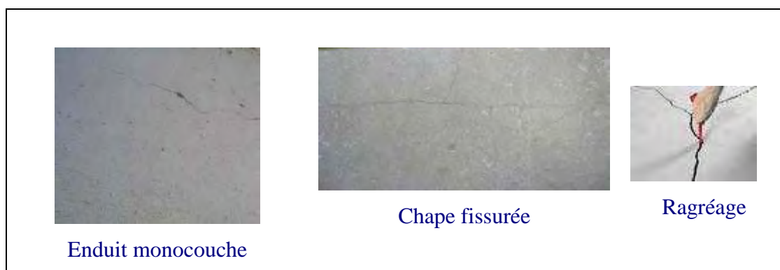
Figure 2 – Fissuration observée sur des structures d'enduits
