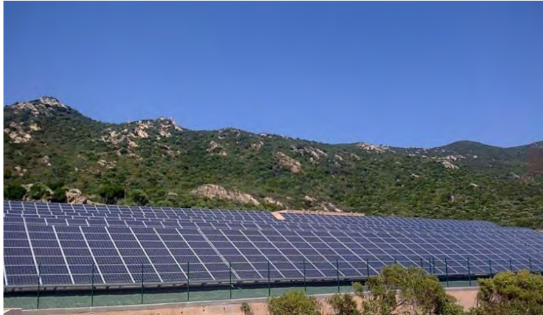
Fig 1-58: Champ photovoltaïque du projet MYRTE
