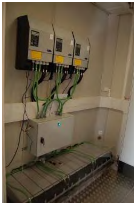
Fig 5-87: Onduleurs Studer et batteries EnerSys
