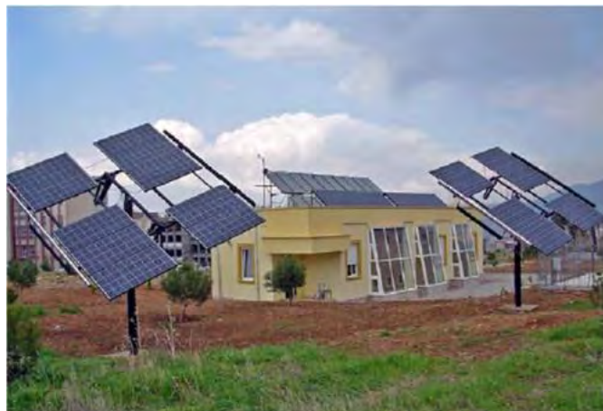
Fig 1-56 : Installations du Clean Energy Center en Turquie
