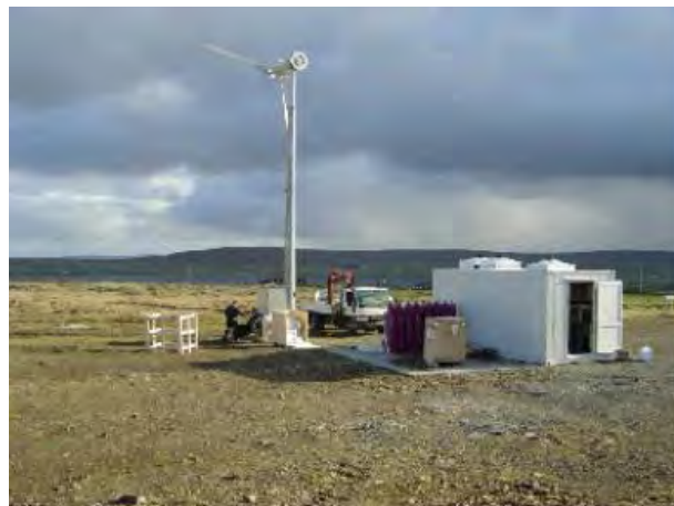
Fig 1-55 : Photo des installations du projet PURE
