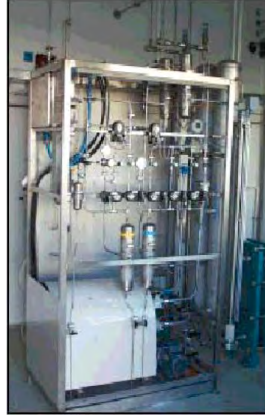
Fig 1-46 : Electrolyseur de Stralsund
