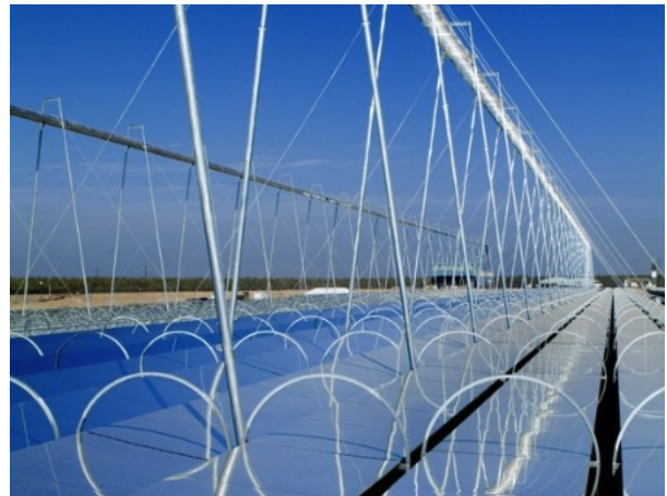
(d) Miroir de Fresnel - Centrale d'Areva (ex Austra) à Bakersfield en Californie.
